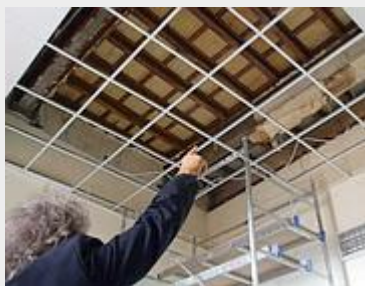
Il cedimento del controsoffitto in un liceo romano (foto Jpeg)
