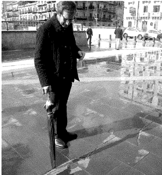
Un passante indica la crepa tra le lastre di marmo della pavimentazione del Tribunale
