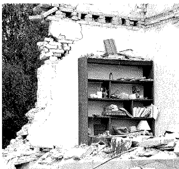
Una casa crollata a Cavezzo
