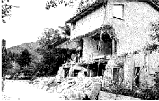
Un'immagine del terremoto che nel settembre del 1997 colpì le Marche
