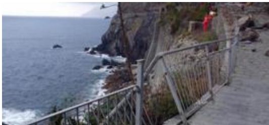
La zona dove è caduta la frana (foto Pistelli)
