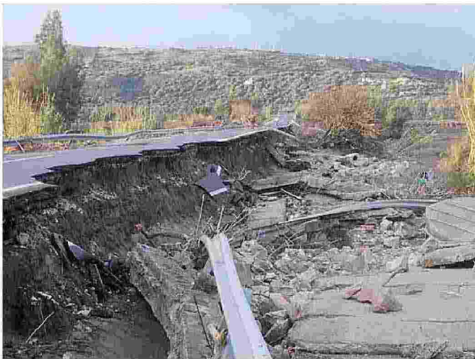
Una delle strade del Nuorese danneggiate dall'alluvione
