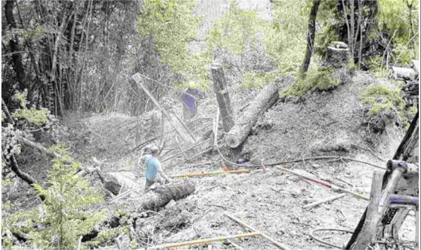
IL CANTIERE I tecnici sulla testa della frana da 6mila metri cubi che sarà fatta scendere con un'esplosione pilotata
