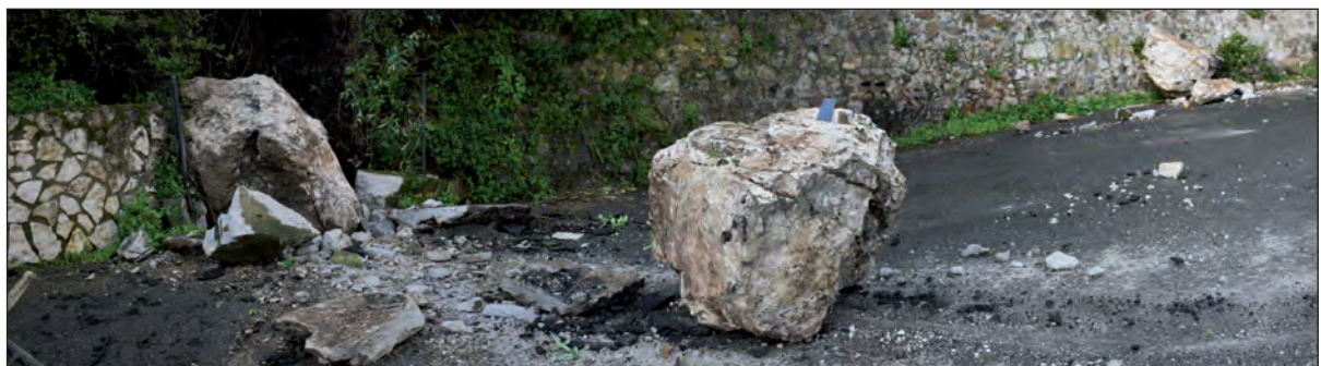
Fig. 5 - Massi caduta sulla SP10
