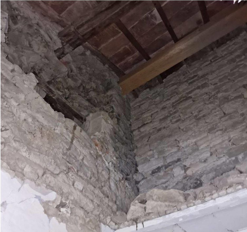
Figura 2 – Altro esempio di parete a sacco letteralmente “esplosa” al seguito del sisma(Credit: Marco Peroni)
