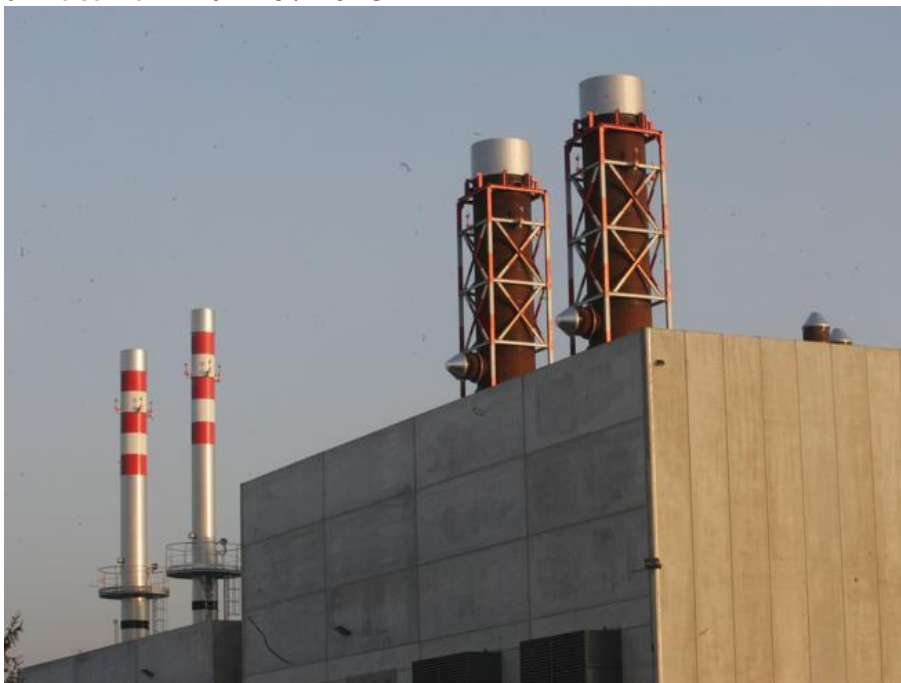
Una centrale di teleriscaldamento a Monza (foto Radaelli)
