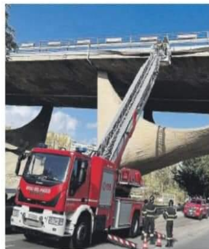
POTENZA Crollo del cornicione dal ponte Musmeci
