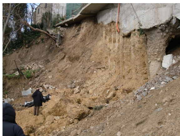
Fig. 5 – Colata di fango lungo una strada provinciale in agro di Salandra (MT) e frana nell'abitato di Salandra (MT) (2014)
