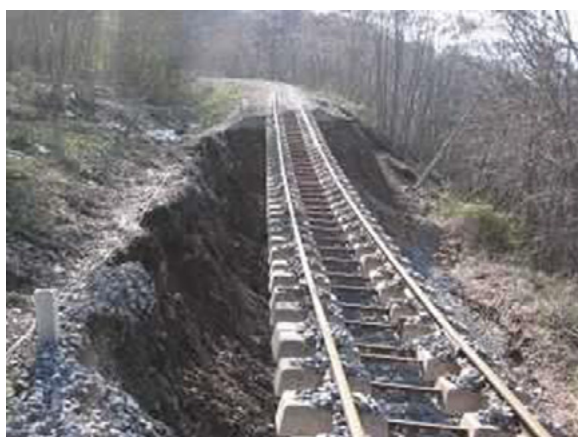
Fig. 4 – Frana strada provinciale in agro di Rogliano (CS) e frana lungo linea ferroviaria regionale.
