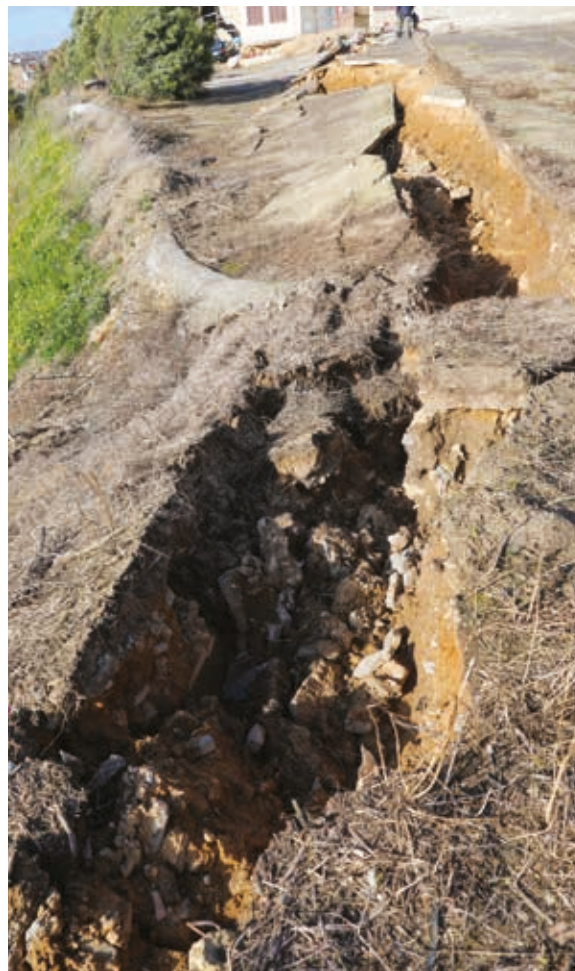
“Frana di Niscemi 2026” di Dipartimento della Protezione Civile, “Niscemi landslide 2026” photo by the Civil Protection Department
