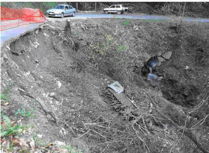
Vista laterale della zona interessata dal cedimento stradale e dello sbocco della tombinatura del rio (Boschi di Corerallo, Genova)
