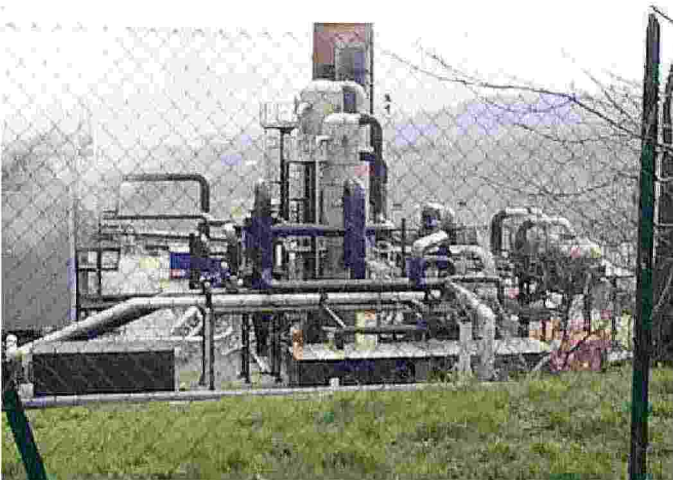
Una centrale geotermica
