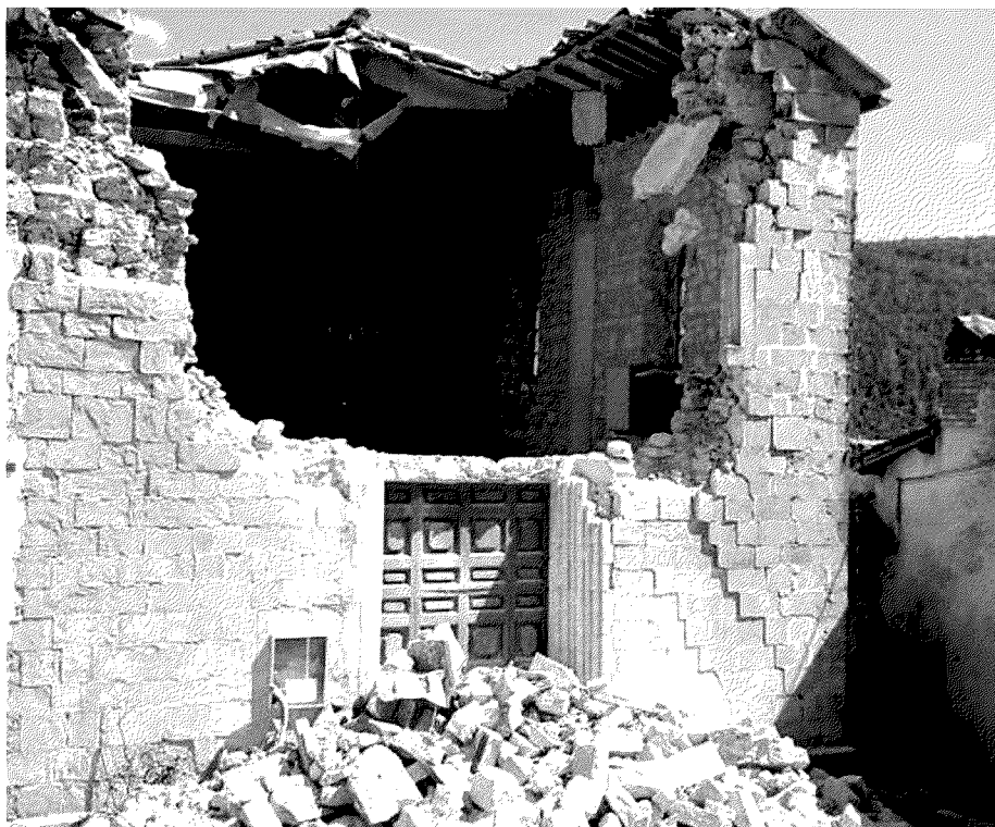
La chiesa di San Francesco ad Accumoli dopo il crollo dovuto alle scosse di terremoto che hanno fatto precipitare il campanile sull'abitazione adiacente provocando la morte di un'intera famiglia
