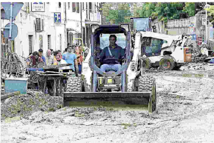
Montenero, ruspa al lavoro la mattina dopo l'alluvione (Marzi Pentafoto)
