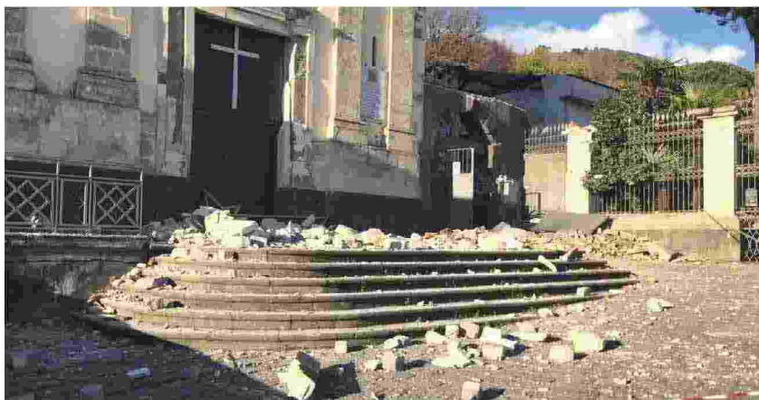
Crolla parte della facciata della Chiesa di Fleri, frazione del comune di Zafferana etnea
