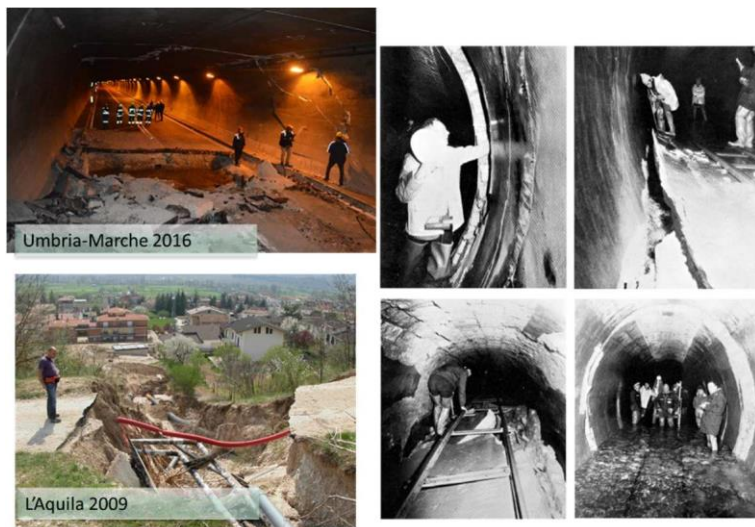
Figura 3. Esempi di danni a infrastrutture dovuti a fagliazione superficiale.
