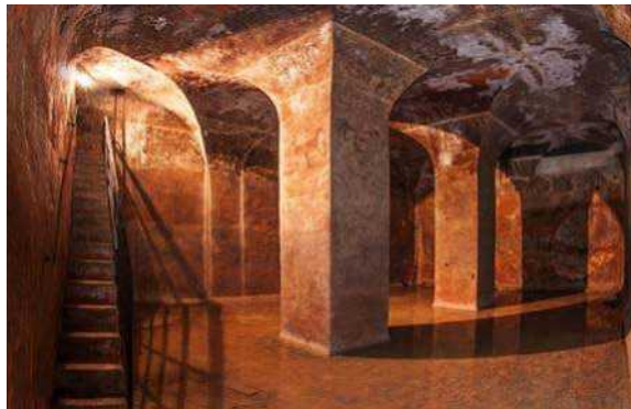
Figura 22 - Vano "a" della cisterna con i due pilastri. Si nota il colore marrone rosso sul pavimento e sui muri fino a circa 5 metri di altezza. Figure 22 - Room "a" of the cistern with the two pillars. Note the red brown color on the floor and walls up to about 5 meters in height.
