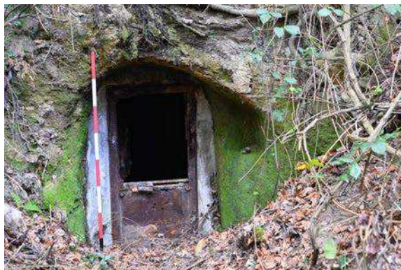
Figura 16 - Ingresso di un cunicolo drenante della sorgente Trinità in sinistra del torrente tributario di sinistra del Fosso della Botte. L'asta è lunga 1,5 m.
